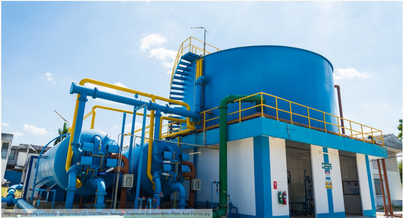
Endüstriyel Atıksu Arıtma Tesisi
