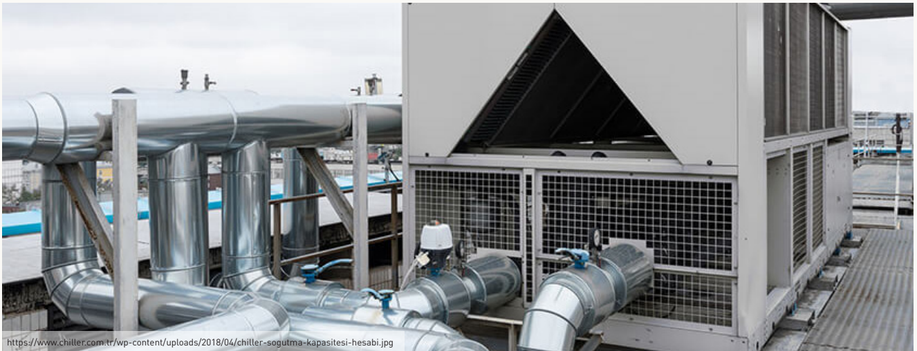
Soğutma Sistemleri (Chiller)
